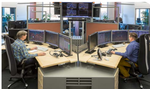
Das Leitstellenpersonal verarbeitet Informationen für die Strom- und Gasversorgung.
